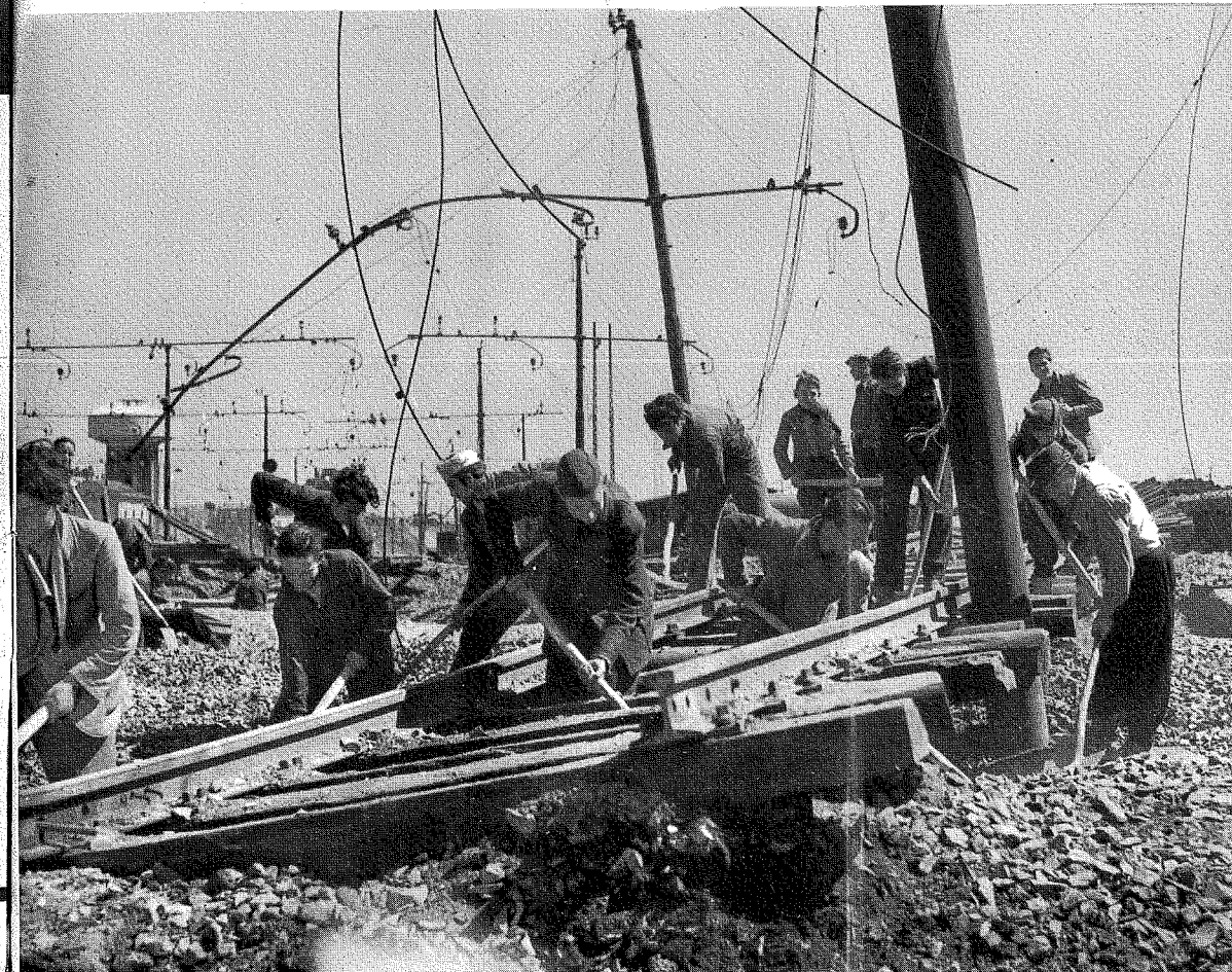
Fig. 2 Uno degli spettacoli, per noi ferrovieri consueti, negli anni tra il 1942 ed il principio del 1945. Linee aeree strappate..... Pali di sostegno divelti..... Locomotive e veicoli ridotti ad ammasso in forme di rottami..... Binari contorti, ripiegati, assai spesso su se stessi..... rotaie strappate dalle traverse, crivellate dalle schegge, attorcigliate nei modi più strani..... crateri immensi determinati dallo scoppio delle bombe di aereo..... le case vicino alla ferrovia smozzicate, sgretolate... La sferza, dopo l'8 Settembre 1943, dell'oppressore che voleva a tutti i costi il lavoro perché i treni continuassero a correre per alimentare una guerra, mai, come allora, senza scopo. (Foto della raccolta del Museo F.S. di Roma).
